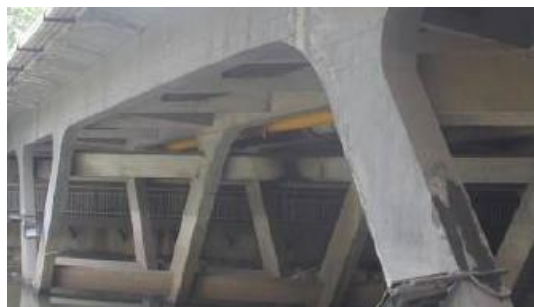
图3 桥梁现状图（一）
