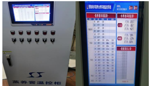
图11 蒸养窑温控柜和蒸养水样环境监控系统
