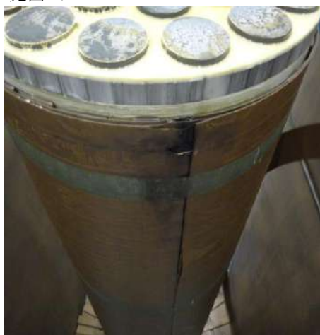
图 5 地屏根部焊接位置前端断裂图
