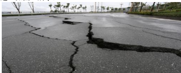
图1 路面不均沉降段路基路面图
