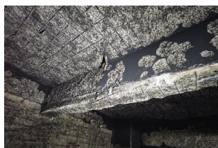
图4 梁混凝土剥落露筋典型图
