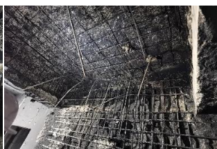
图5 楼板混凝土剥落露筋典型图
