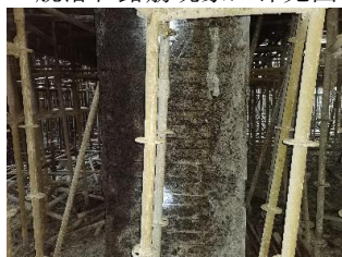
图2 柱混凝土剥落露筋典型图
