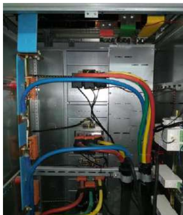
图 5 低压柜内背面照片
