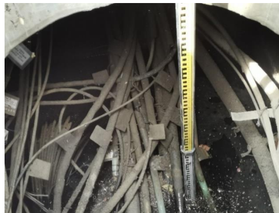
图1 错综复杂的管线
