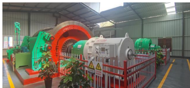
图6 阎家庄风井广场项目回风建井项目JKZ-3.6 \times 3PY永磁同步减速电机直驱提升机
