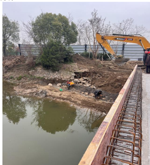
图1 老驳坎塌方事件施工现场
