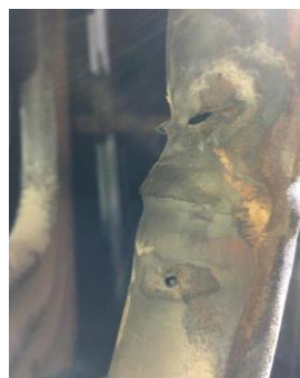
图 2 夹持管焊接接头漏点示意图
