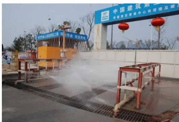
图2 南京某建筑项目的扬尘处理设备
