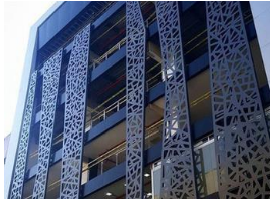
图4 某建筑外幕墙装饰板
