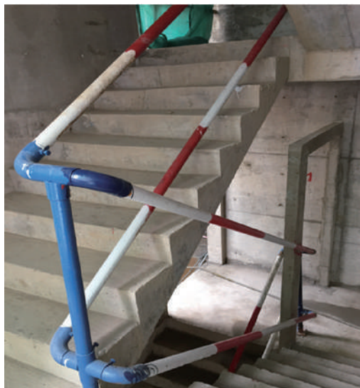
图 6 工具式楼梯临边防护栏杆
