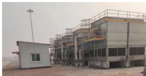
图1 密闭式冷却水塔现场图
