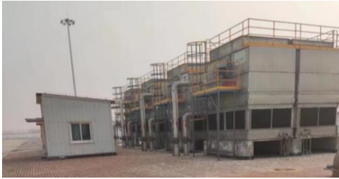
图1 密闭式冷却水塔现场图
