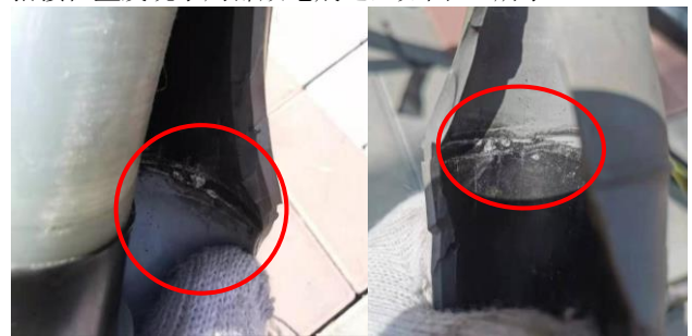
图 20 电缆终端应力锥内侧放电痕迹
