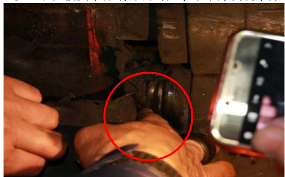
图11 接头端部阻水带下方存在水分
