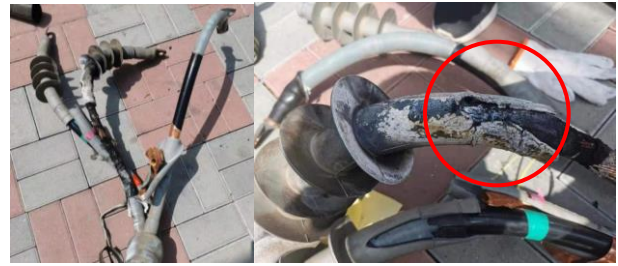
图 17 电缆终端三相应力锥弯折严重
