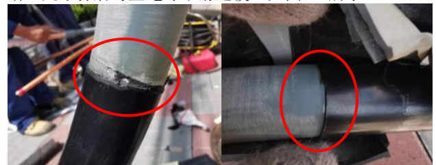
图 19 电缆外半导电断口工艺不良
