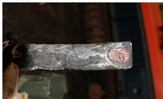
图13 压接管端部导体已熔断
