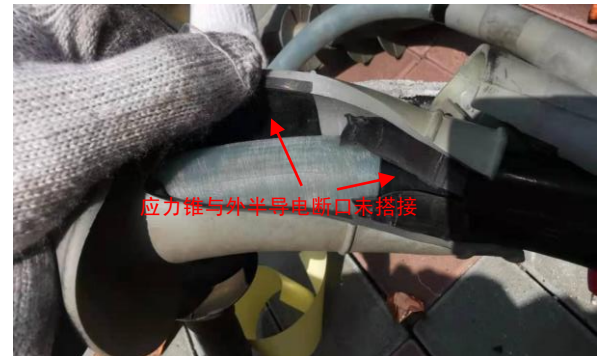
图 18 电缆终端应力锥安装尺寸明显错误
