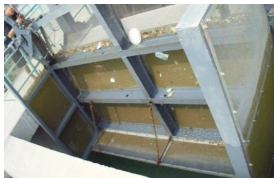
图5 总干渠漕河渡槽出口拦网所拦杂物
