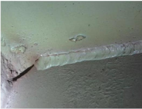
图 2 13-14 线/C 轴吊车梁上翼缘与加劲肋连接焊缝开裂
