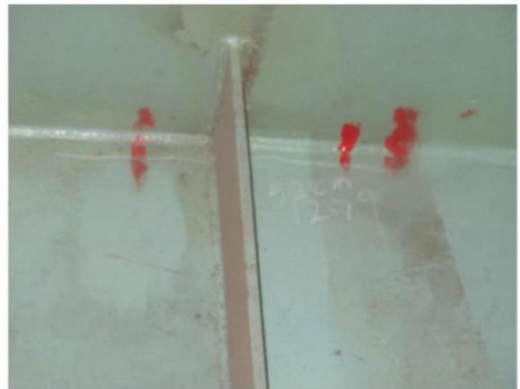
图 4 8-9 线/D 轴吊车梁上翼缘与腹板、加劲肋连接焊缝开裂，长度 520mm
