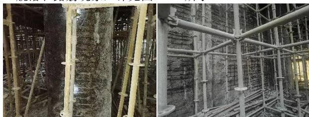
图2 柱混凝土剥落露筋典型图 图3 墙混凝土剥落露筋典型图
