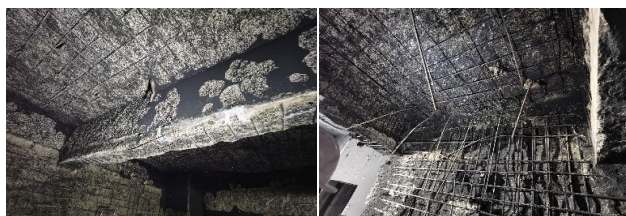
图4 梁混凝土剥落露筋典型图 图5 楼板混凝土剥落露筋典型图
