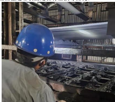
图5 输送带表面磨损检查
