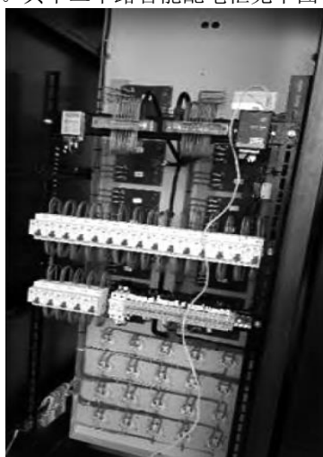
图5 智能配电柜内部图
