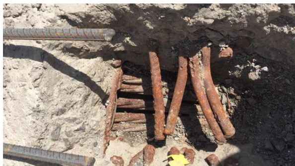
图2 压浆孔道堵塞问题
