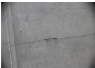
图 14 塔大桩号立面 19#节段 右下角露筋
